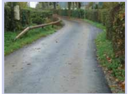
Réfection de l'impasse de la Planche Aménagement d'un virage avec installation de protection.
